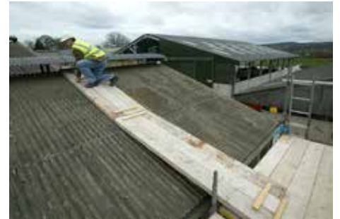
Utilizați panouri pe acoperișurile fragile.
