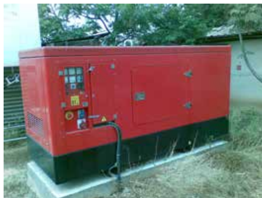
Mențineți generatoarele în stare bună de funcționare.
